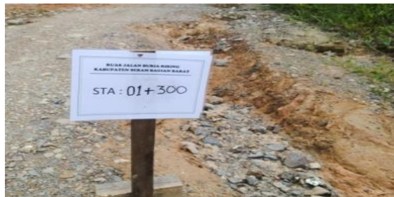
Gambar 3. Kerusakan Struktur Perkerasan
