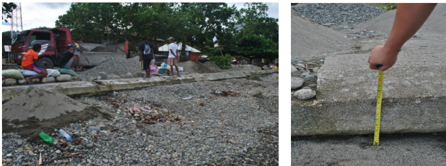
Gambar 2. Talud yang semakin dangkal
