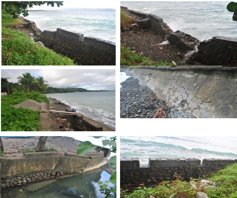
Gambar 3. Kerusakan Talud Penahan
