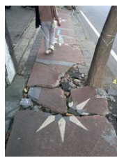
(B) Kerusakan trotoar dan jalur sempit di segmen B sisi kiri
