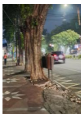
(a) Kerusakan jalur trotoar di segmen A sisi kiri
